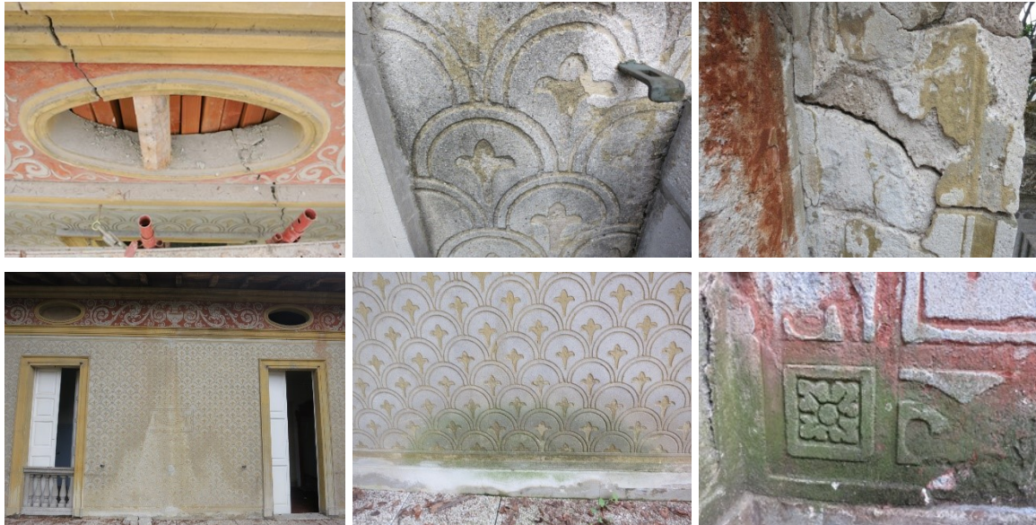
Abbildung 6: Schäden an der – verhältnismäßig gut erhaltenen – Fassade
